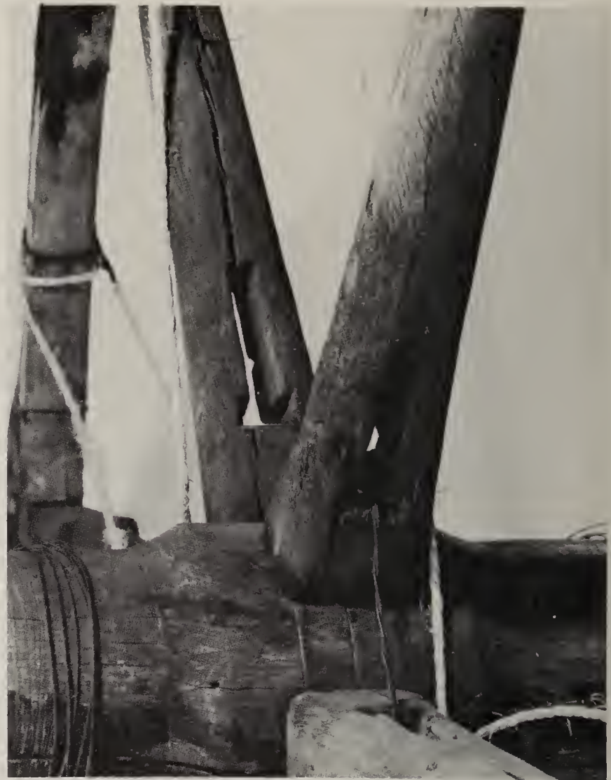
Fig. 2 - La roue vue de 3/4, montrant les ouvertures en forme de T renversé au quart inférieur des faces internes des rais.
