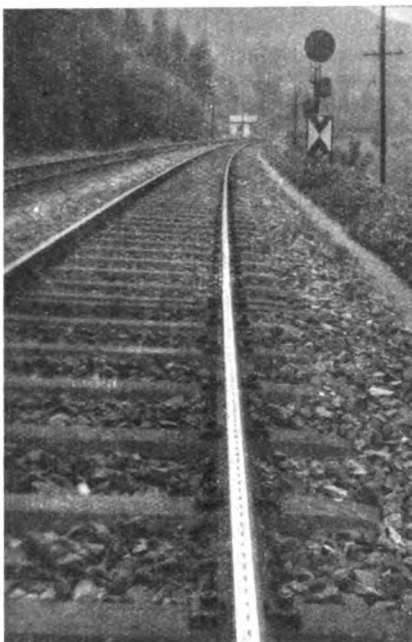
Abb. 1. Riffeln in der verlegten Schiene.
