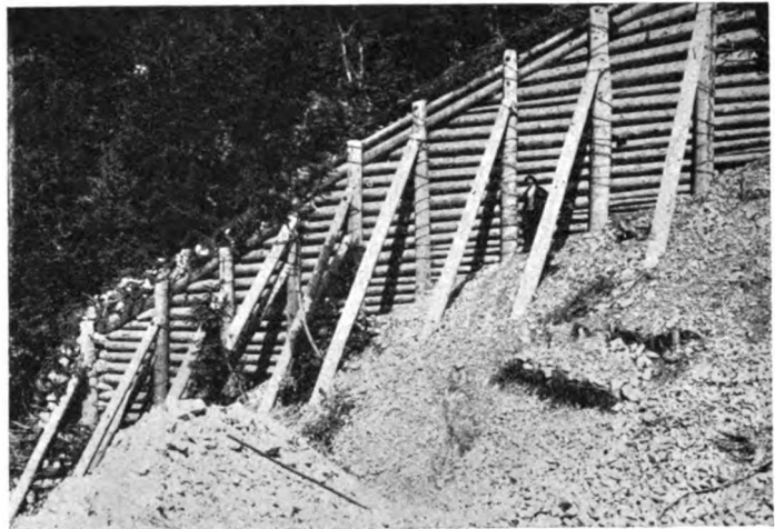
Abb. 6. Großer Holzverbau im Gypsbruchtobel bei km 119,7/8 der Strecke Innsbruck—Bludenz.
