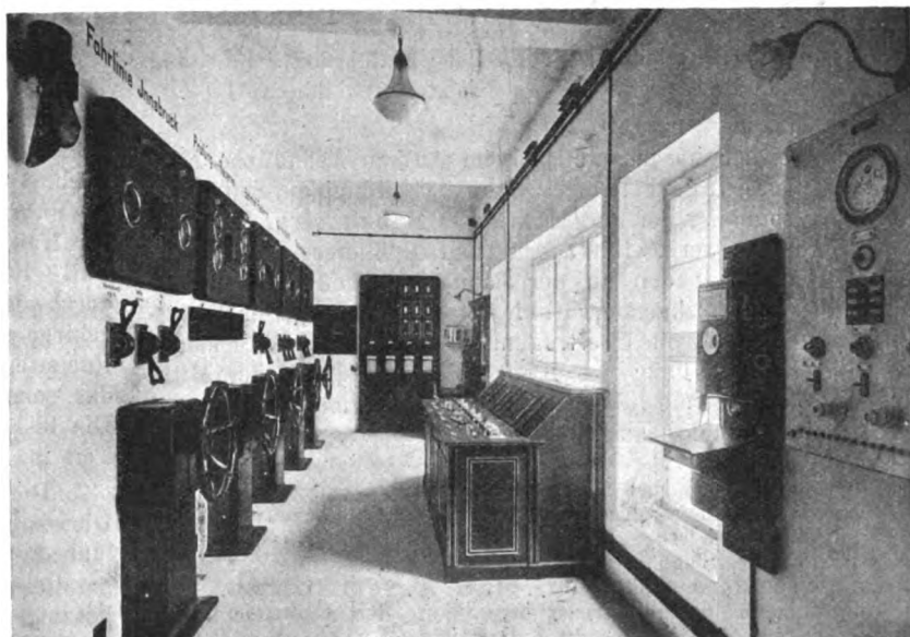
Abb. 24. Unterwerk Feldkirch: Befehlsraum.
