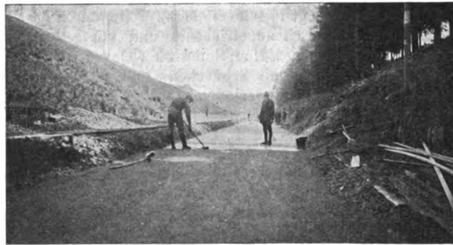
Abb. 9. Schutzschicht Teerasphalt (4 bis 5 cm stark) für die wasser-dichte Abdeckung bei Brücken (zwischen den beiden Pfeilern).
