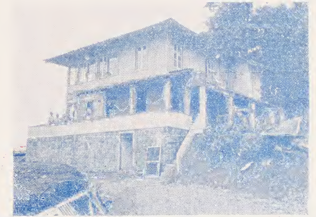
Casa en construcción con envidiables vistas panorámicas a través de varias hermosas terrazas, propiedad del señor Rodolfo F. Herbruger, a 3,000 pies de altura, con manantial de agua en su propio lote.
