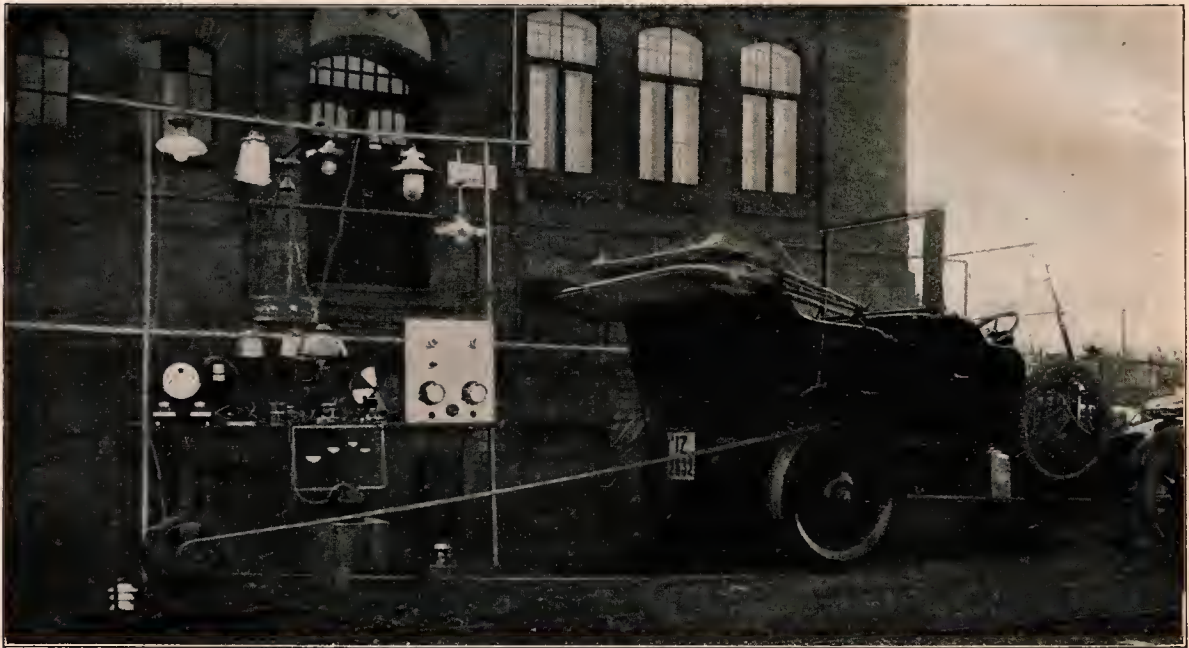
Wertwürdige elektrische Apparate: Das Automobil als elektrische Zentralstation. Zur Vorbereitung für die Einführung der Elektrizität werden in Friedenszeiten von den Elektrizitätsgesellschaften und Werken in Kraftwagen aufs Land und in kleine Städte Ingenieure gesandt, die dort Vorträge über den Nutzen des elektrischen Stromes halten. Dabei wird dessen vielseitige Verwendung vorgeführt. Der Strom wird durch den als elektrische Zentrale dienenden Kraftwagen selbst Dynamo erzeugt.
