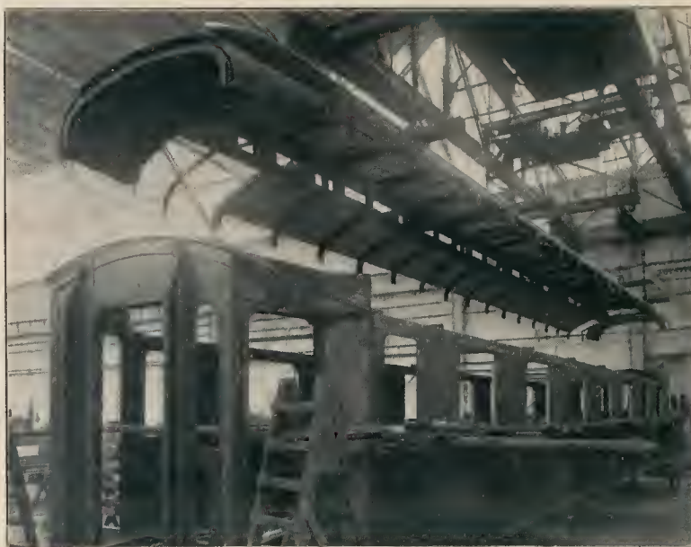
Eiserner Personen-D-Zugswagen. Besonders beachtenswert ist die Konstruktion des Daches und der Stirnwand mit den starken eisernen Säulen.
