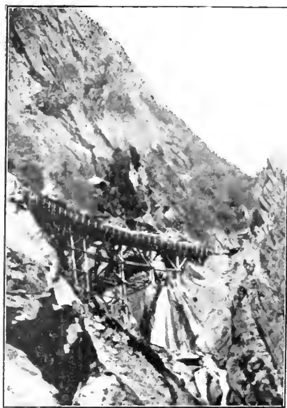
FIG. 13. — Pont provisoire pour la voie de service.
