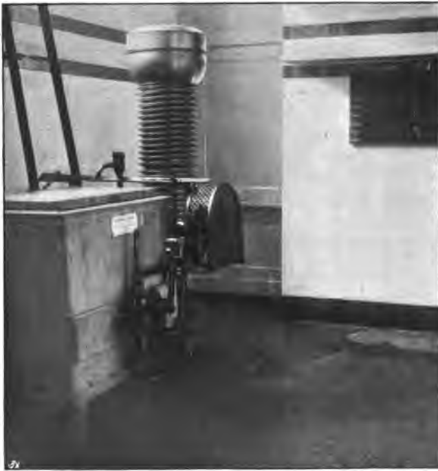
Fig. 10. Milchraum mit Kühlanlage.
